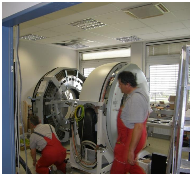
Abbildung 6: Installation der PET/CT- Anlage der Praxis für Nuklearmedizin, PET/CT und Molekulare Bildgebung des Asklepios Klinikum Harburg
