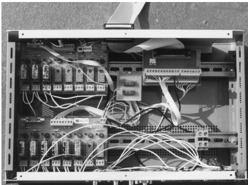
Abb. 7: Aufsicht auf den Schaltkasten zur Verknüpfung des Mess- und Regel-PC mit den Messinstrumenten und der Probenahme-Einheit.
