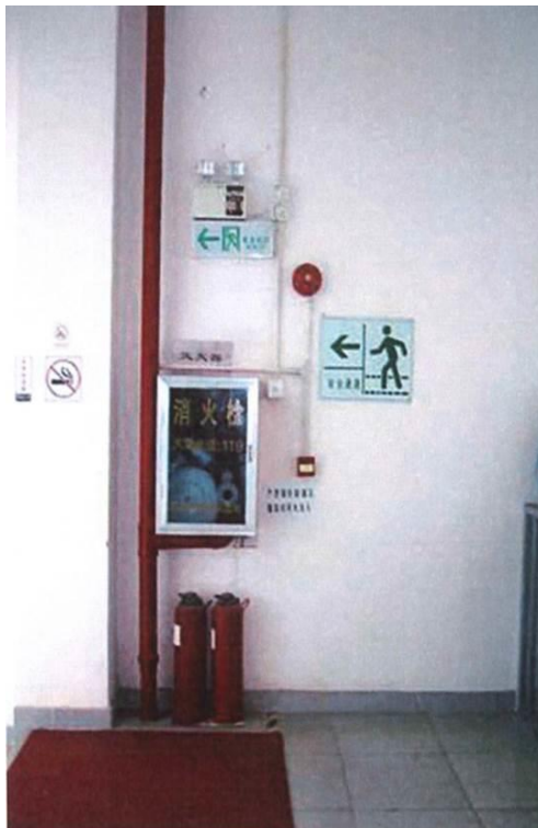
Abb.36: Vorbildliche Brandschutzeinrichtung (ungehinderter Zugang zur Einrichtung, Vorhandensein von Feuerlöschern und Löschschlauch, deutliche Fluchtwegkennzeichnung, akustischer Feueralarm) (Privataufnahme mit freundlicher Genehmigung von Esther Tse, 2009)
