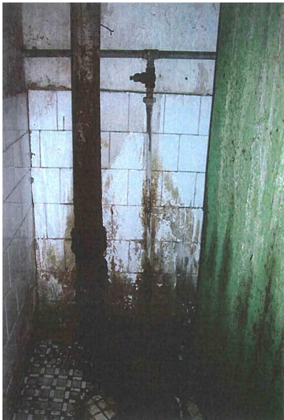
Abb.42: Sanitäranlage - Negativbeispiel (Privataufnahme mit freundlicher Genehmigung von Esther Tse, 2009)
