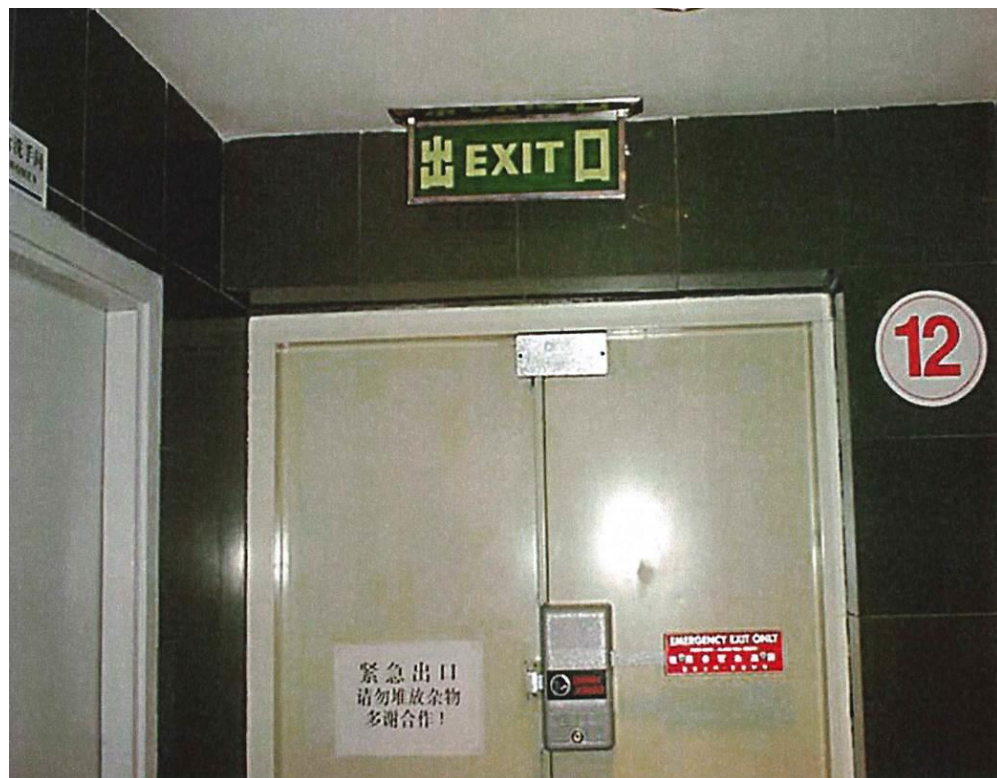
Abb.40: Notausgang – beleuchtete Kennzeichnung 609
