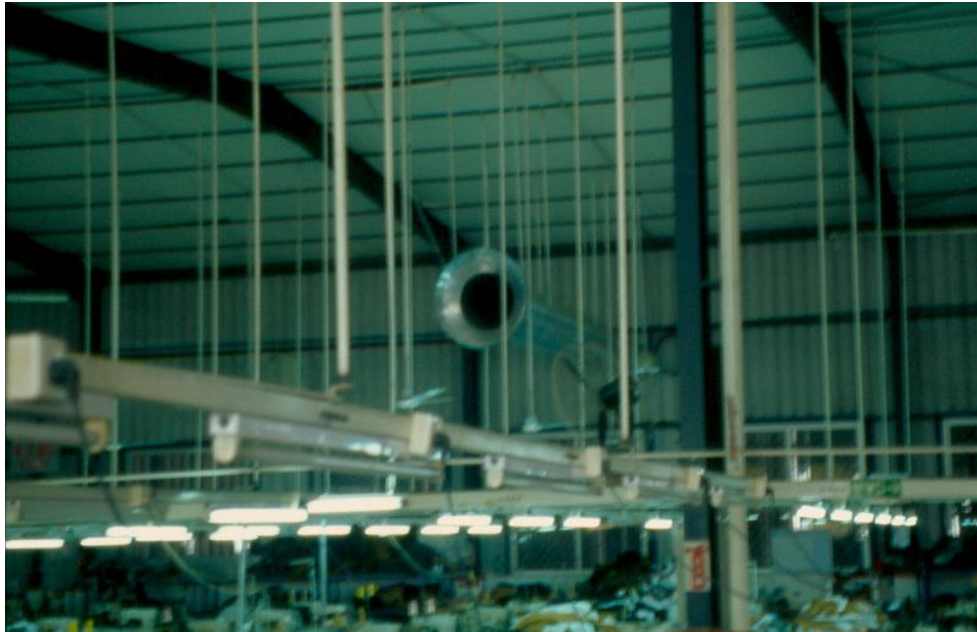
Abb.19: Moderne Lüftungsanlage – Chaida zhiyichang youxian gongsi 岱制衣厂有限公司 ( Chai Da Garment Co./Timberland ) (Privataufnahme 2011)
